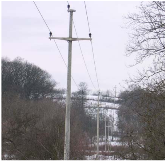
Fig. 7. 10 kV – Overhead line “ KRAVLJI DO -ŠLJIVOVAC “ ( J.P. “ELEKTROMORAVA “, Požarevac )
